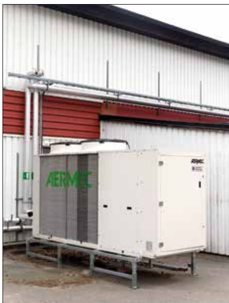
Aermec NRK enhetsaggregat med 100 kW värmeeffekt är kopplat till befintligt ventilationssystem.
