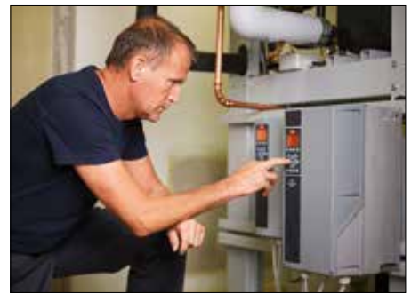
Webbaserad styrning och övervakning som både Kent och handlaren har tillgång till. Ovan en frekvensomformare till en av kylkompressorerna vars funktion kan kontrolleras via webben.
