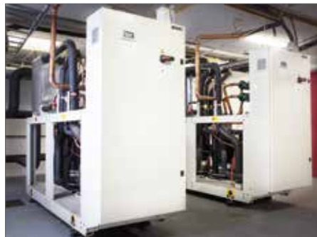
Två vätskekylaggregat från Aermec på vardera 350 kW och totalt åtta kompressorer betjänar idag 18 000 kvm i gallerian.
